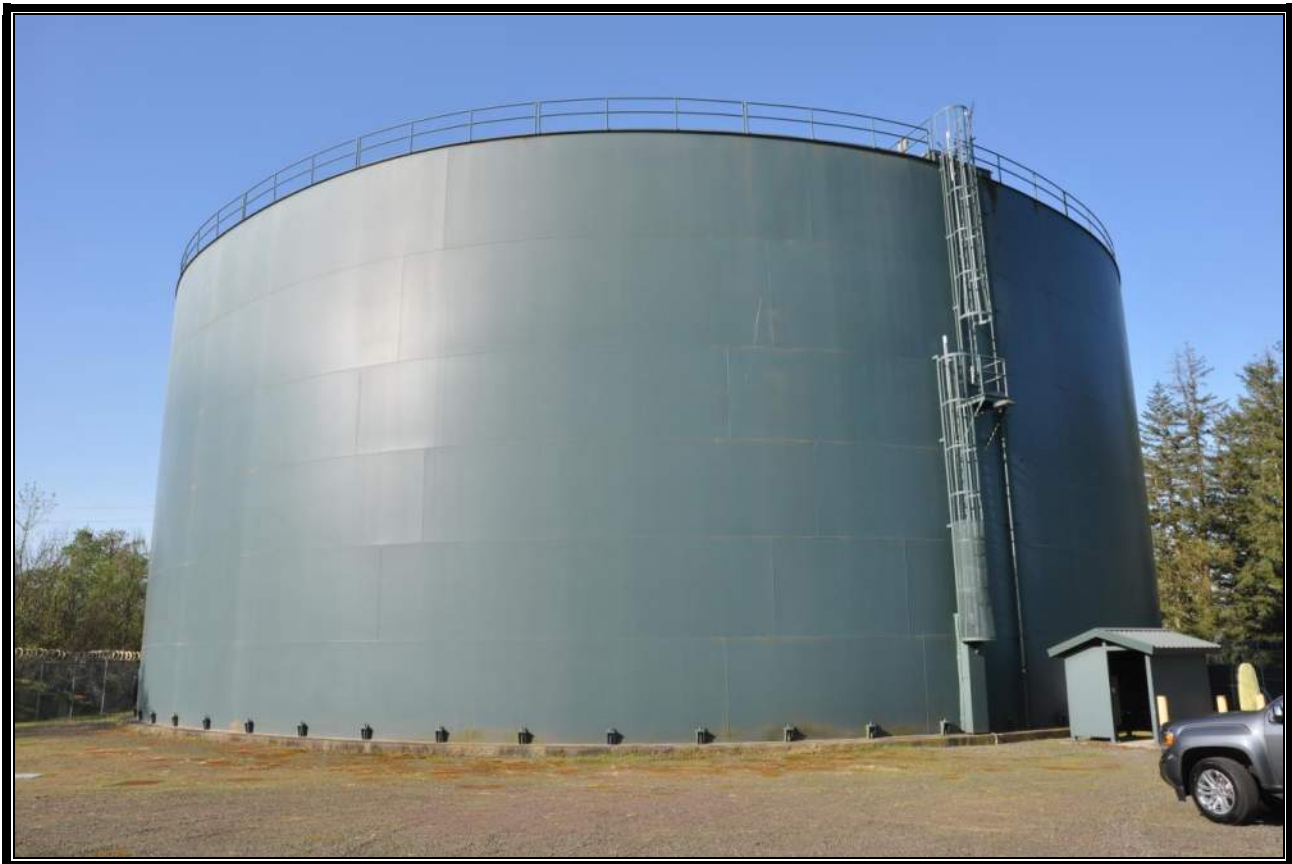
5.0 MG A2 Reservoir
