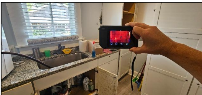
29. Moistuer behind wall
