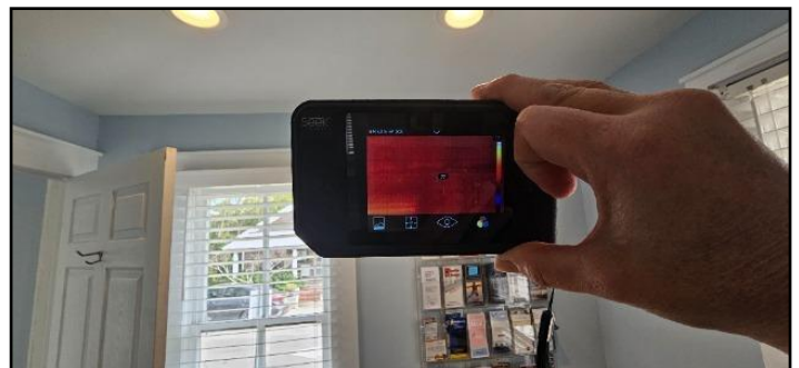
30. Moisture above window
