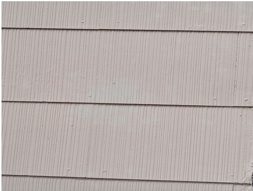
Old Siding - Asbestos
