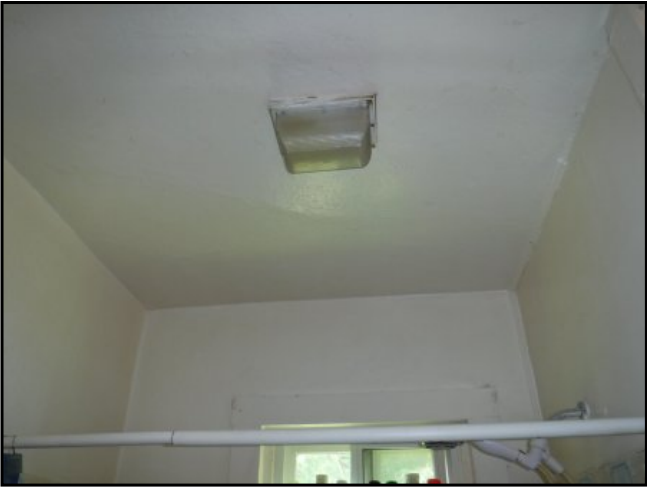
93 : Older exhaust fan
