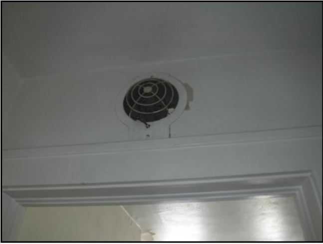
94 : Original exhaust fan
