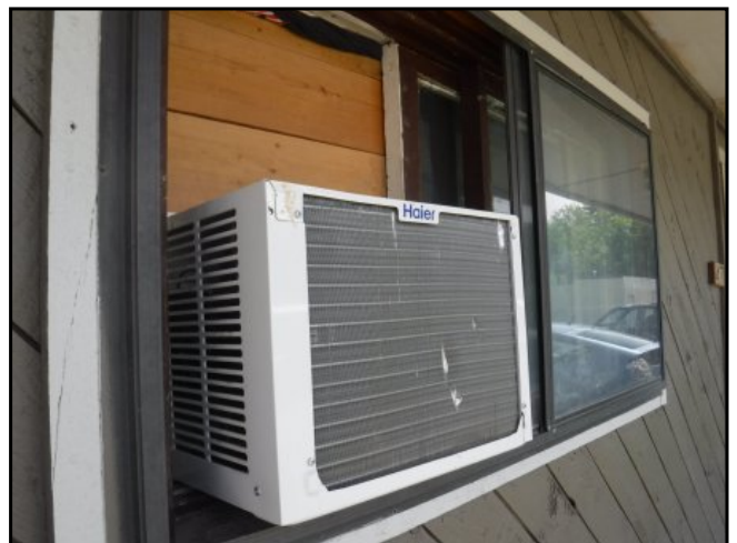
90 : Poorly installed tenant AC unit
