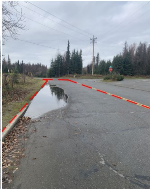
C DAMAGE REGION C3 SCALE: NTS
