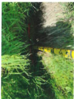
exposed cable.jpg 834K
