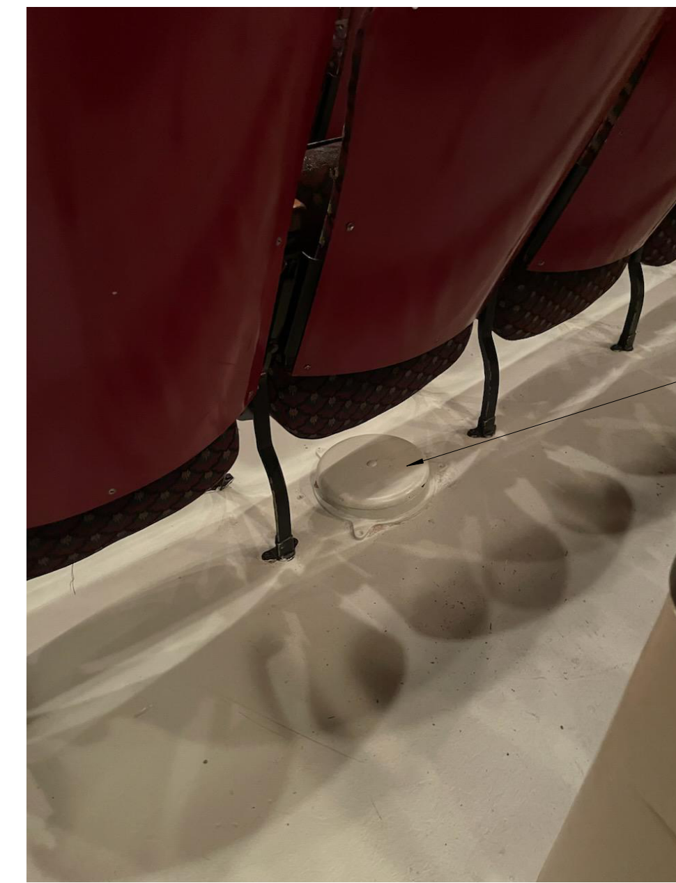
EXISTING METAL CAP - (1)
