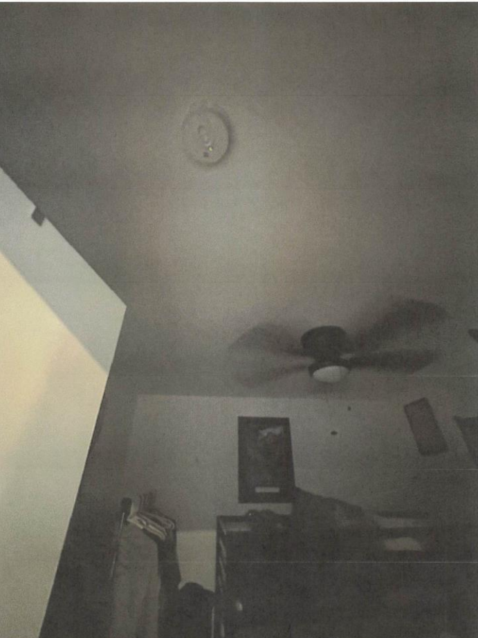
Smoke / CO2 Alarms
