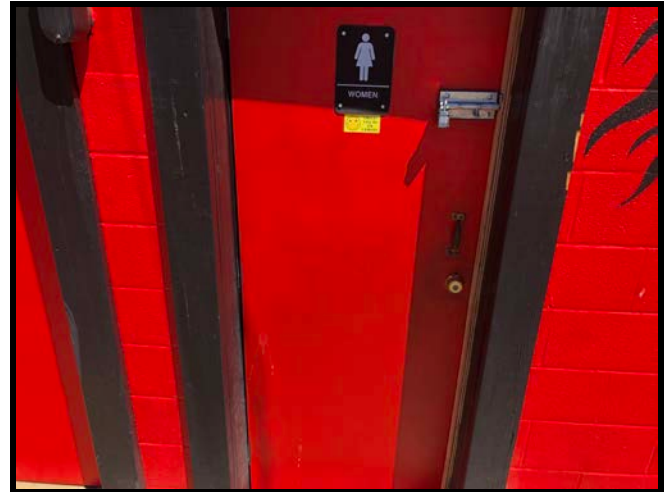
J.W. Johns Jr. Restroom Door Too Small
