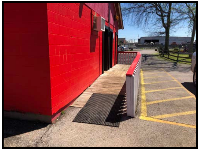
J.W. Johns Jr. Restroom Ramp Slope
