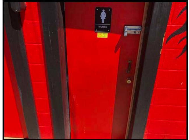
J.W. Johns Jr. Restroom Door Too Small
